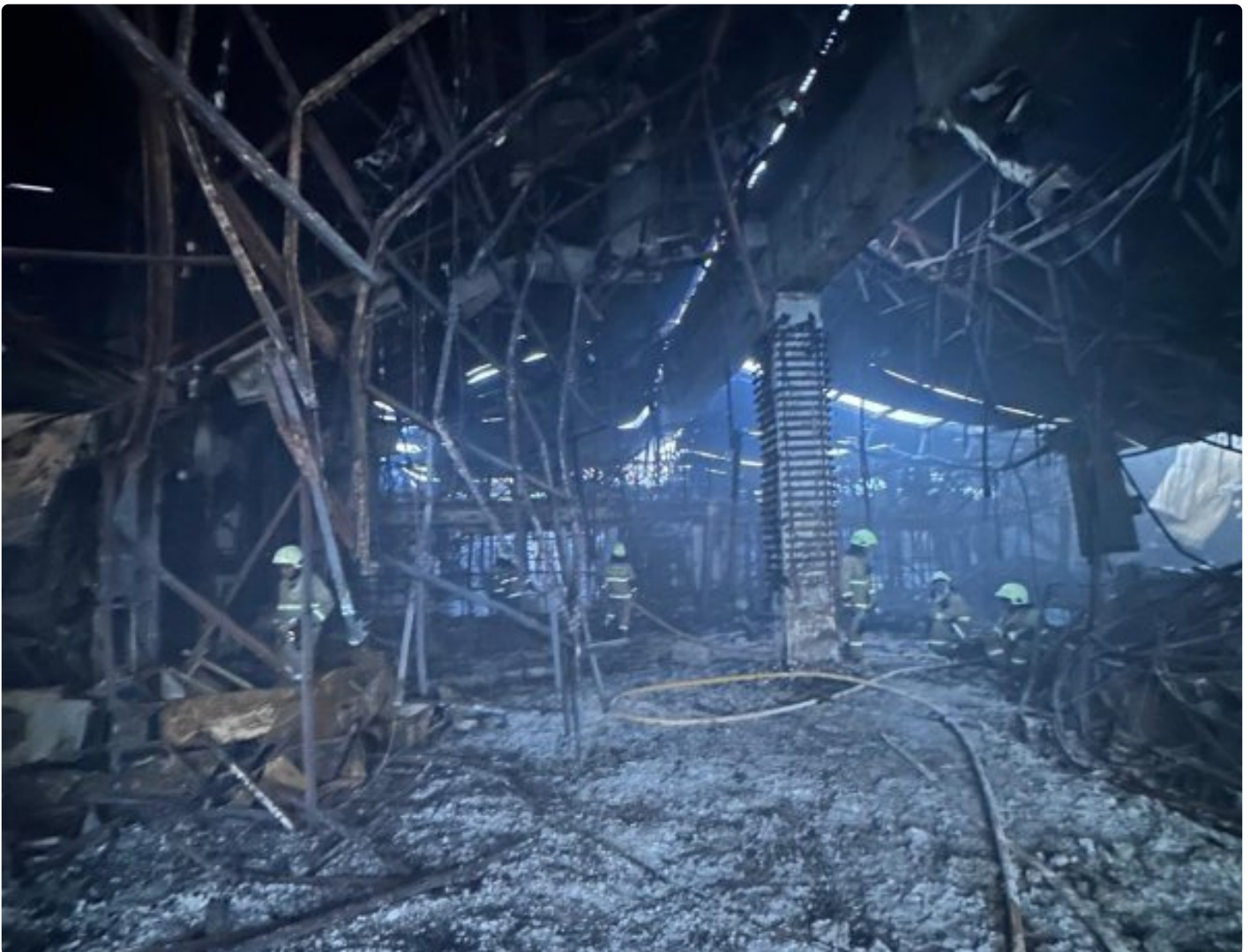
Glodok Plaza yang Hangus Terbakar
